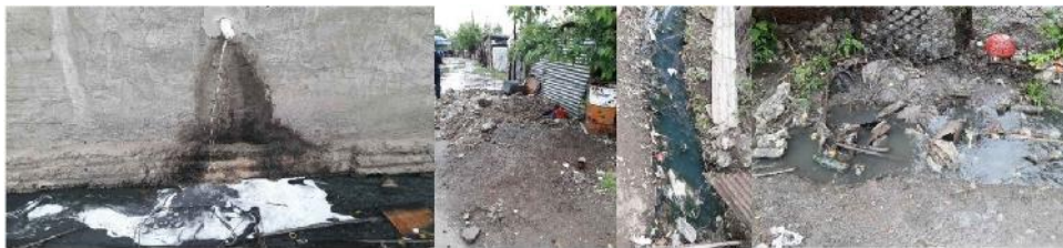
AGUAS GRISES, DESAGÜES A CIELO ABIERTO
