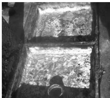
Cámara separadora interceptoras
