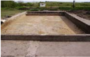
Cámara de retención de grasas
