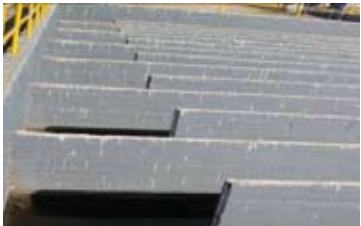
Cámara de desinfección
