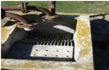
Reja de limpieza manual
